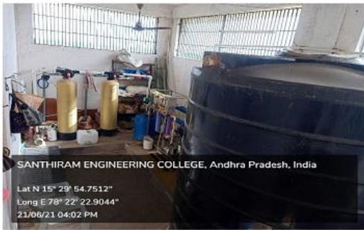
Fig: RO PLANT
